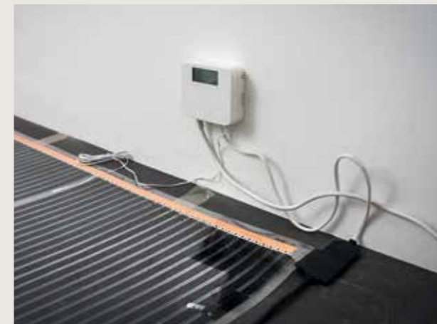
5 Sätt i styrenhetens elkontakt i vägguttaget.
